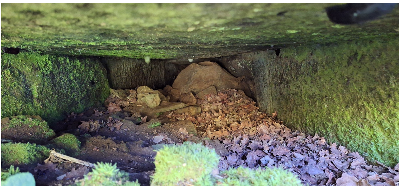
Conducto de entrada del agua
